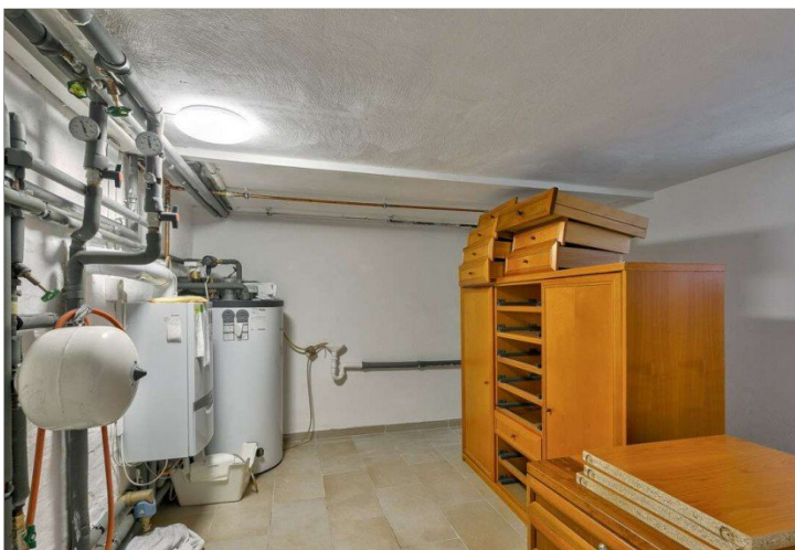
Heizungsraum mit Gas-Zentralheizung (Vaillant)
