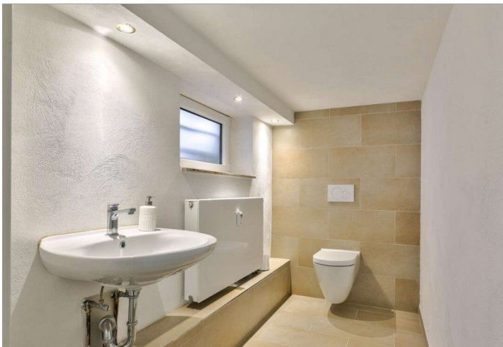
WC-Anlage im Kellergeschoss (Gemeinschaftsbereich)
