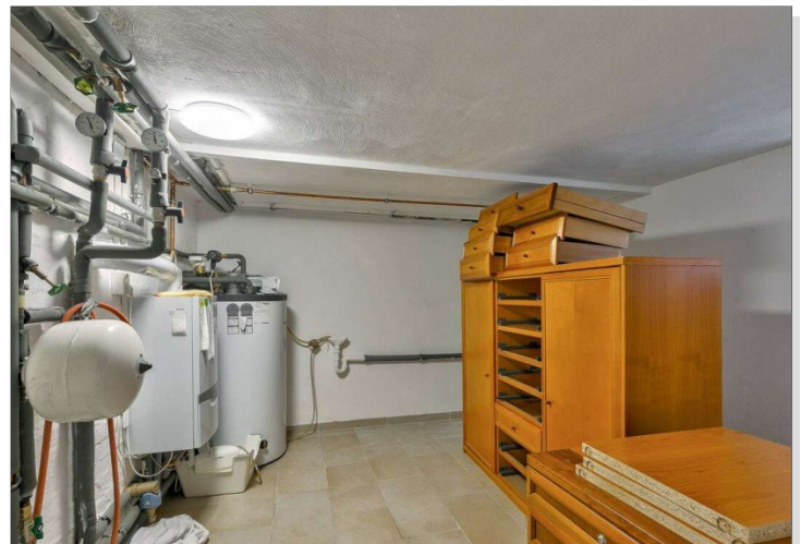
Heizungsraum mit Gas-Zentralheizung (Vaillant)
